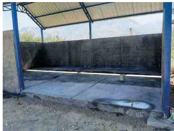
Almacenamiento de material reciclable
